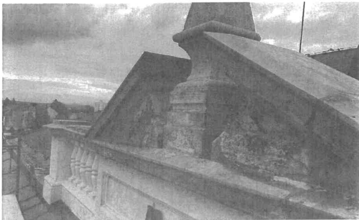
obr. 4 Detail tympanonu - spárování, kombinace materiálů (kámen a umělý kámen-cement), silné vrstvy cementovaných zčernalých depozitů na povrchu
