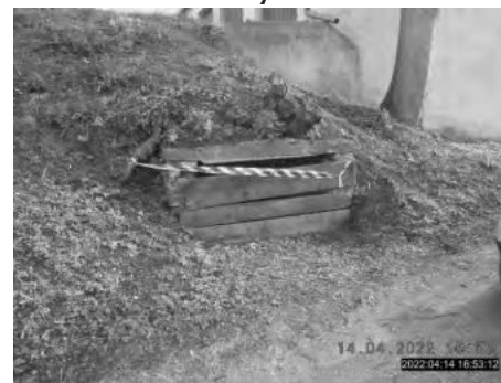
Poškození bednění při vstupu do sklepení bývalého pivovaru. Foto archiv MP
