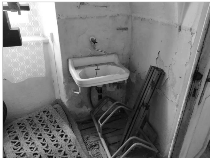
Interiér kovárny vypadá dnes žalostně.
