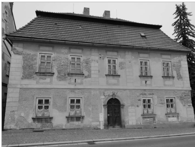
Budova kovárny je ve špatném stavu.
