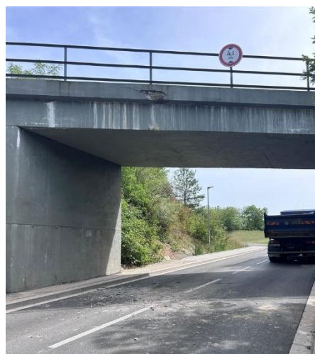
Poškozený viadukt v Zelené ulici.
